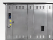
Banco de Capacitores de Media Tensión
